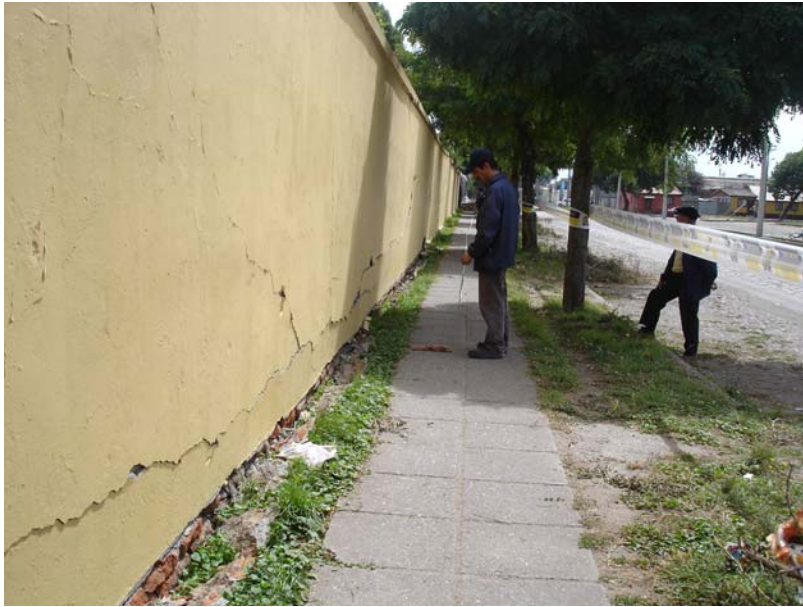
VISTA ACTUAL MURO EXTERIOR AGRIETADO EN SU BASE HORIZONTALMENTE
