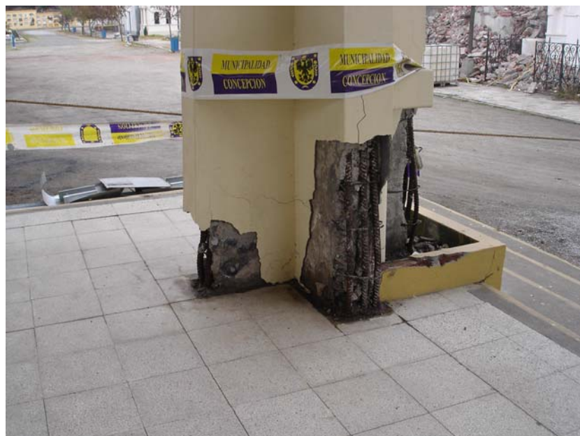
PILAR COLAPSADO EN SU BASE
