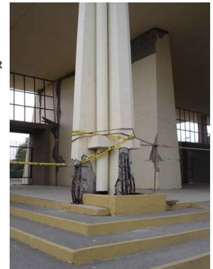
PILAR COLAPSADO EN SU BASE
