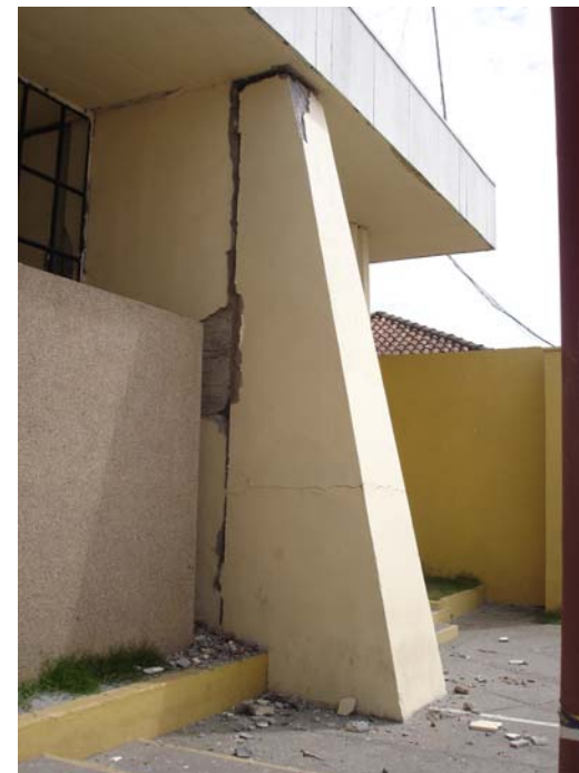
DETALLE EXTERIOR MURO AGRIETADO
