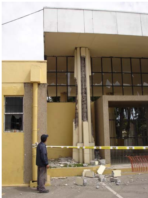
DETALLE EXTERIOR PILAR AGRIETADO
